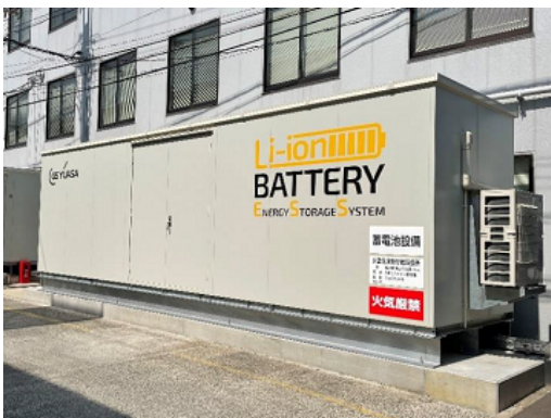
コンテナ型電力貯蔵システムの外観
