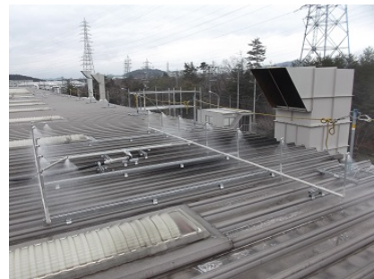
工場の屋根に設置した散水設備(長野事業所)
